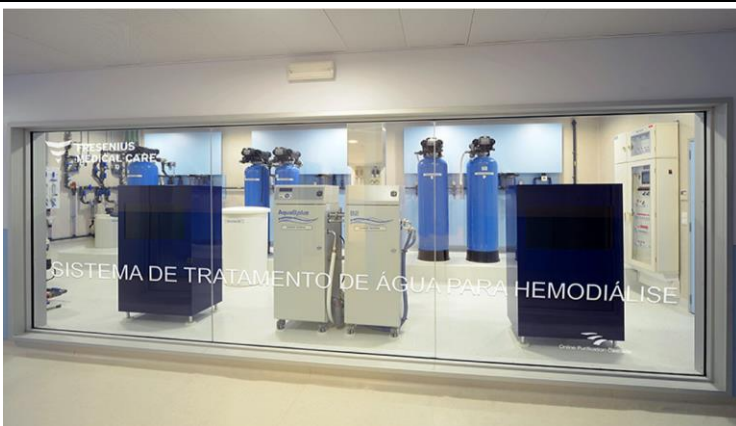
Sala de tratamento de águas para HD
